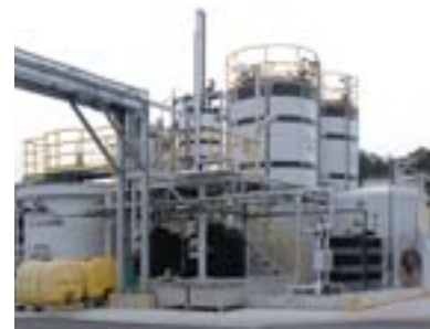
排水処理設備
