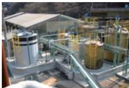
飛灰の湿式処理実証化試験設備(中和設備)
