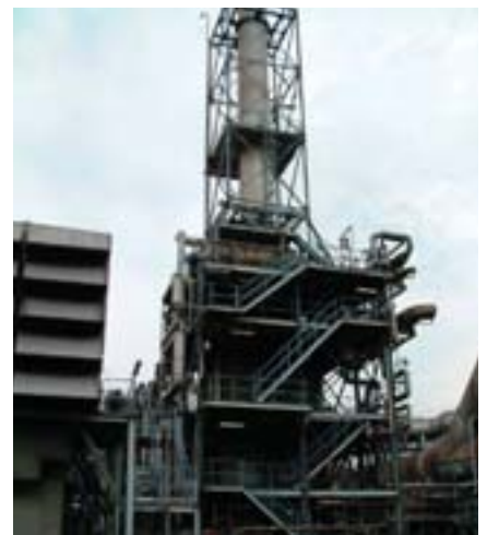
ボイラー廃熱回収設備
